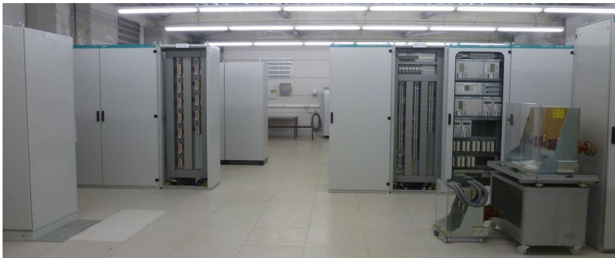
Figure 1.6 : équipements secondaires d'une sous-station
