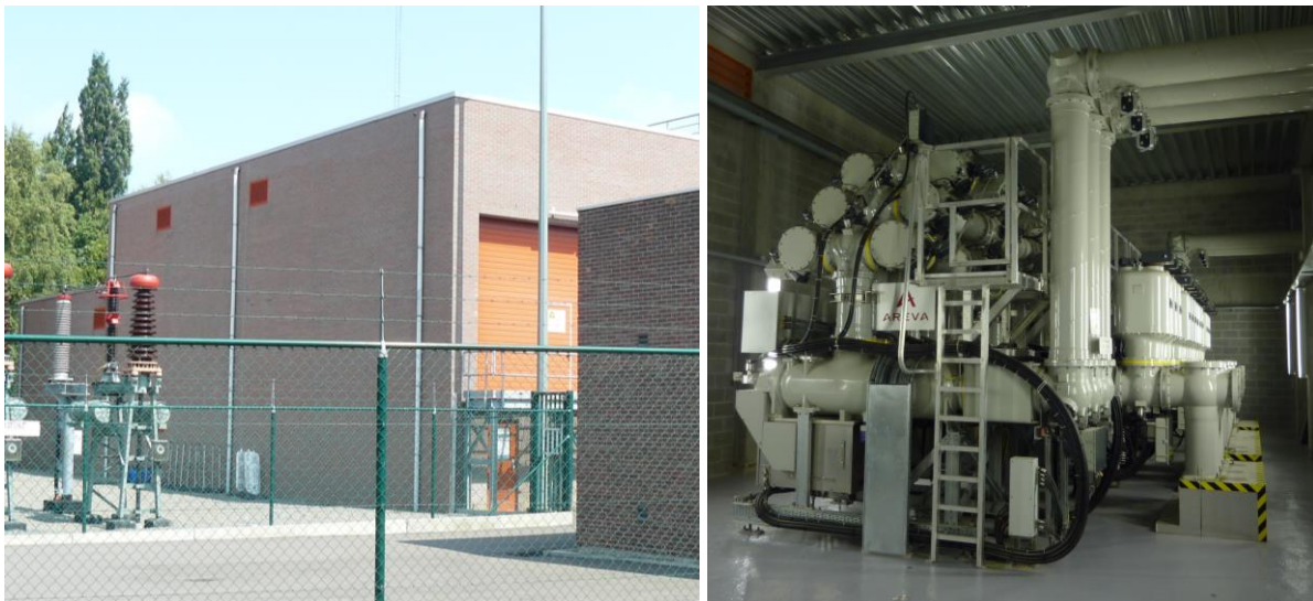
Figure 1.5 : sous-station 150 kV de type GIS
