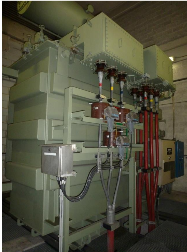
Figure 1.3 : câbles souterrains connectés sur un transformateur
