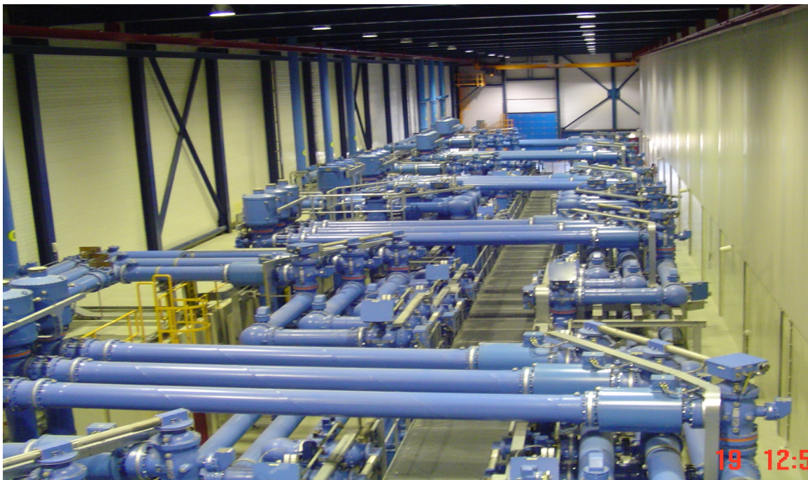
Photo 9-3: travées 380 kV isolées au gaz (GIS)
