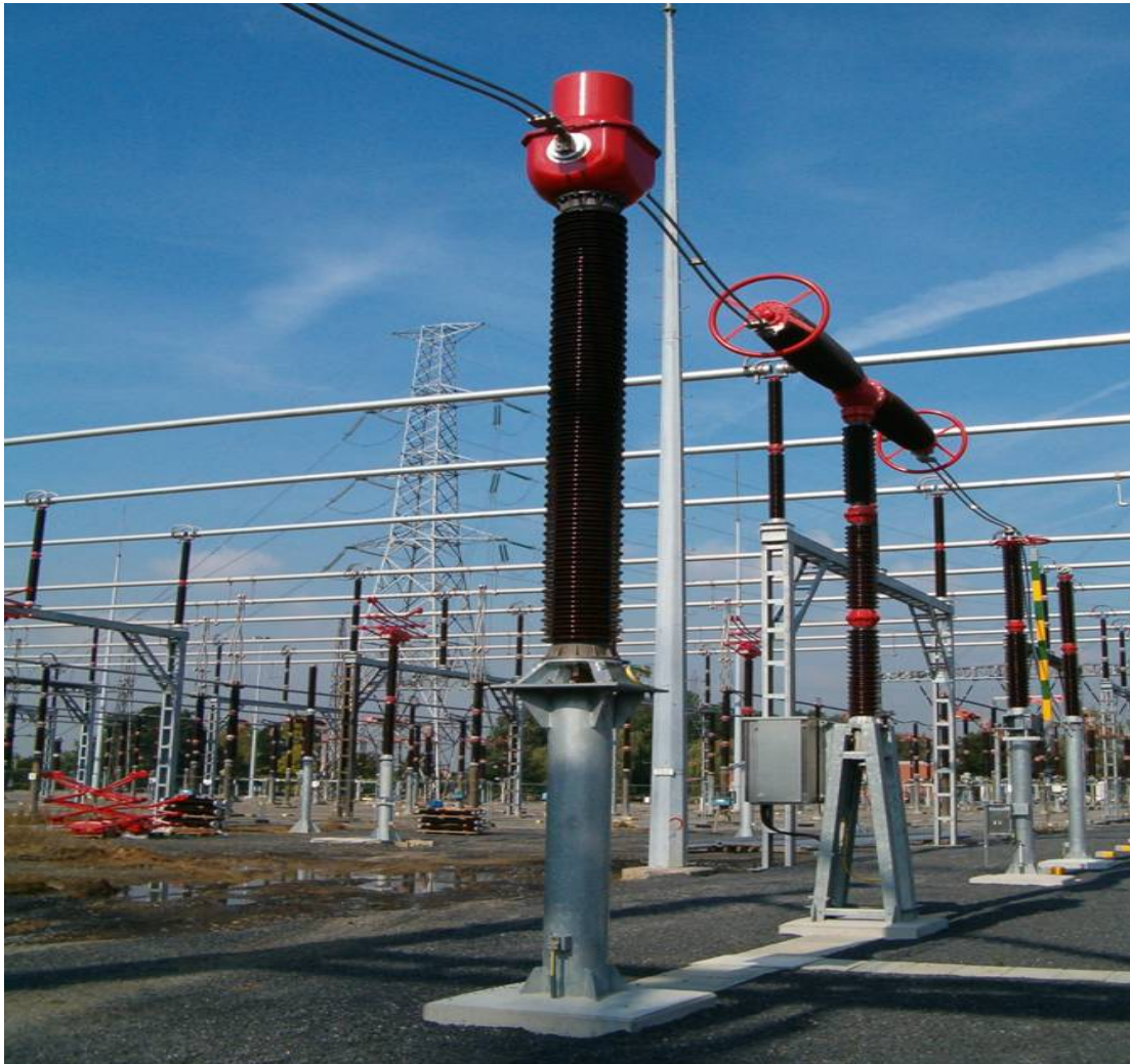
Photo 9-6: transformateur de courant et disjoncteur à l'arrière.
