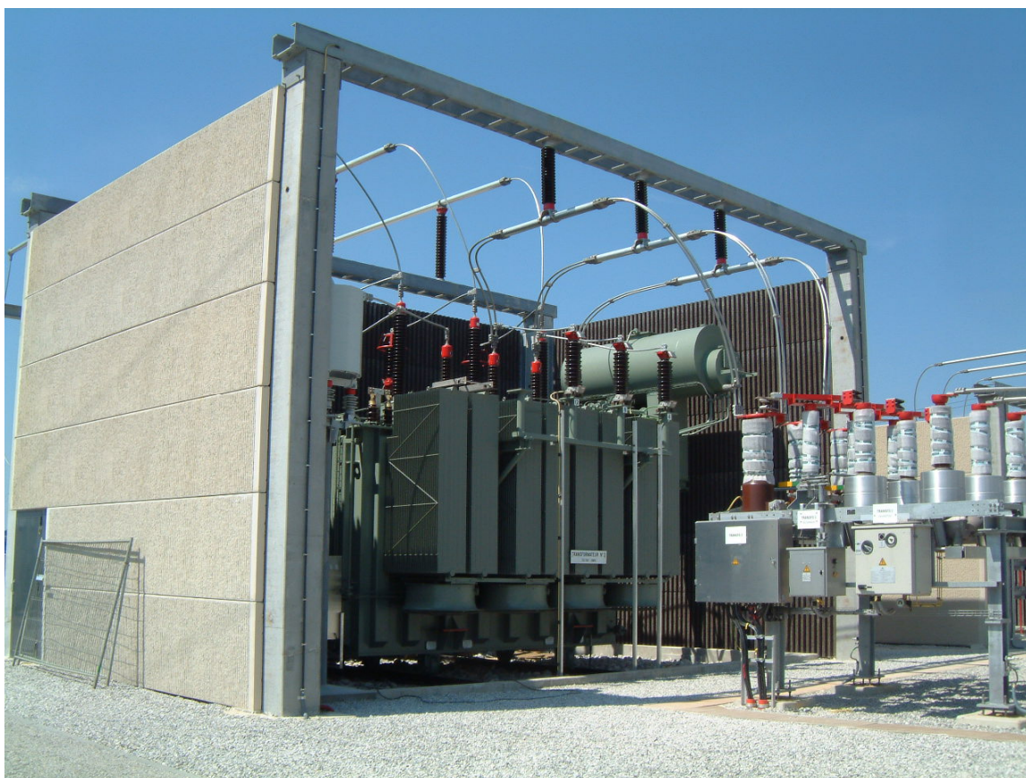
Photo 9-1: transformateur de puissance 380/150 kV placé au-dessus de cuves de rétention en béton et entouré de murs antibruit.
